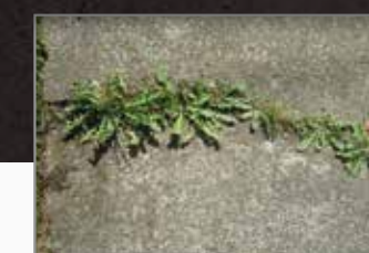
Ukrudt på fortovet
